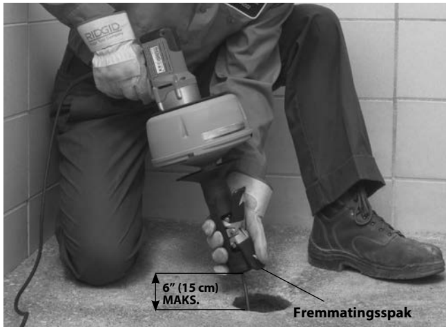
Figur 10 – Mating av kabel med AUTOFEED
