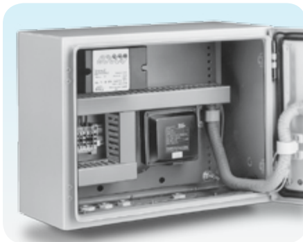
TC 4 separat von der Anlage im Schaltschrank eingebaut
